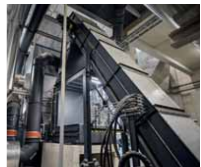
Brennstoff- und Primärluftzuführung
