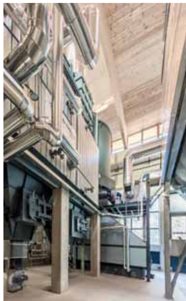
Blick auf den Thermoölkessel und den Stufenrost
